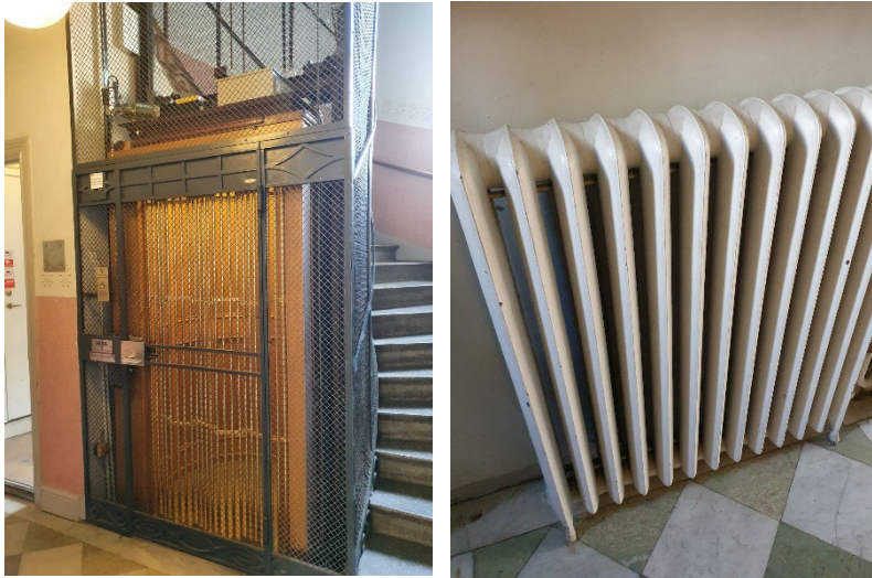
Bilder. Interiöra bilder från gatuhuset inom Doppingen 2, som visar hisskorg i trappspindel och dörr till hiss (WSP 2017).
